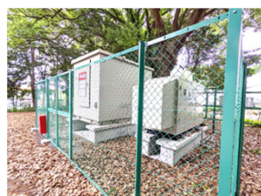
井水飲用化設備用の発電機
