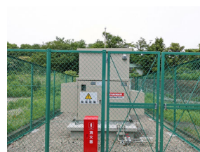
主要電源設備管理システムのための発電機
